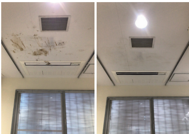
便が付着した天井と清掃後
